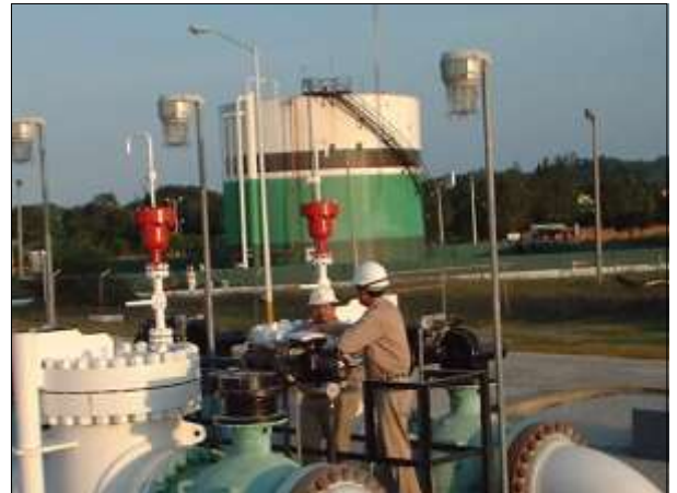
Figuras 4.6.3. Mantenimiento a válvulas.
