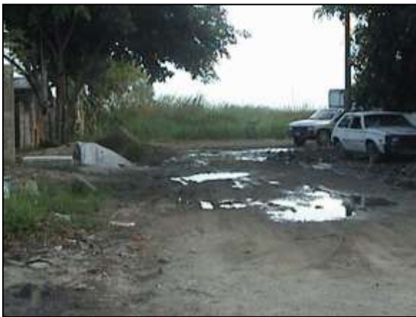
Imagen 4.- Calle Hidalgo Altamira Tamaulipas, no cuenta con guarniciones, banquetas y pavimento hidráulico.
