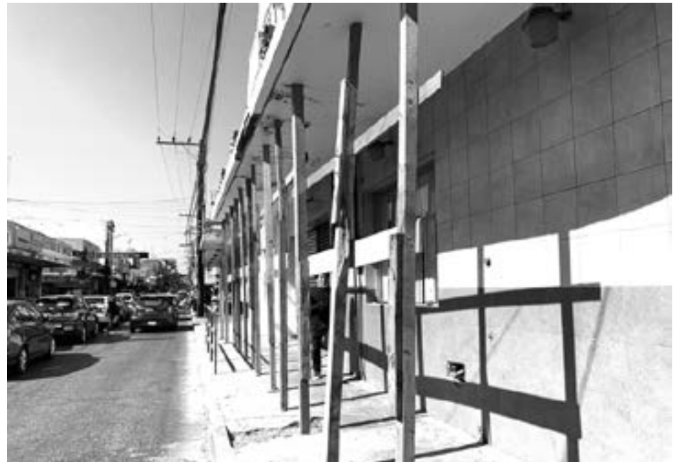
LA SECRETARÍA de Desarrollo Urbano solicitará a los propietarios de edificios de riesgo que los reparen.
