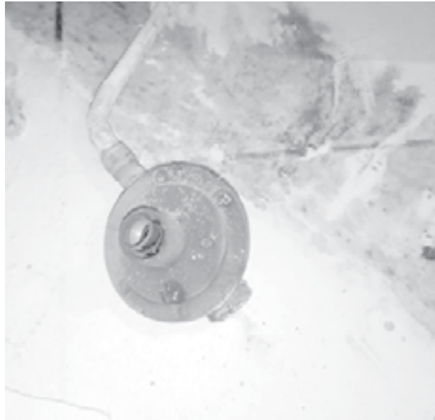
UN TANQUE de gas provocó la fuerte explosión.
