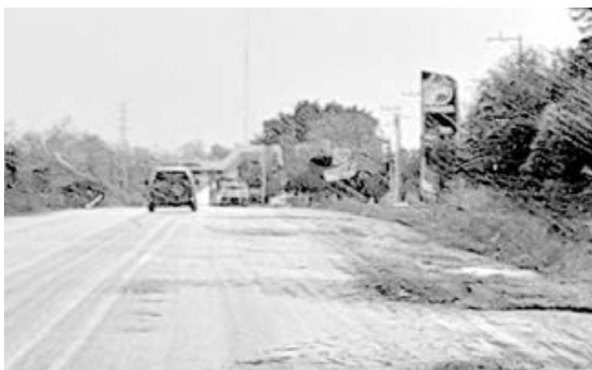
CARRETERAS EN TERRIBLE ESTADO y usuarios pagando por usarlas.
