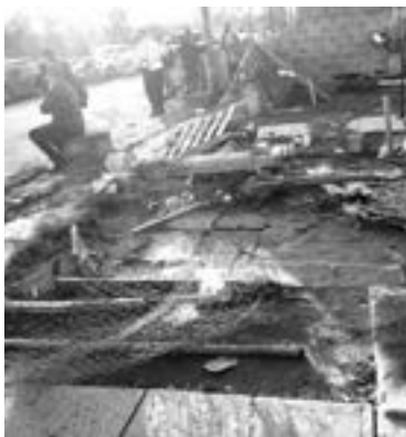
LA EXPEDITION derribó el cercado de la vivienda
