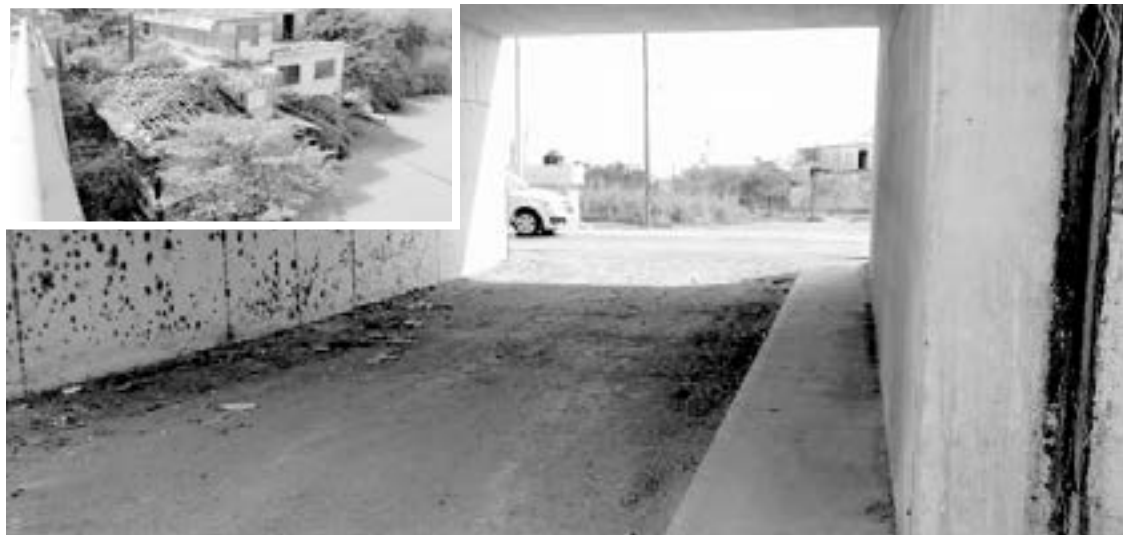
ESTE VIADUCTO fue mal realizados desde el principio.
