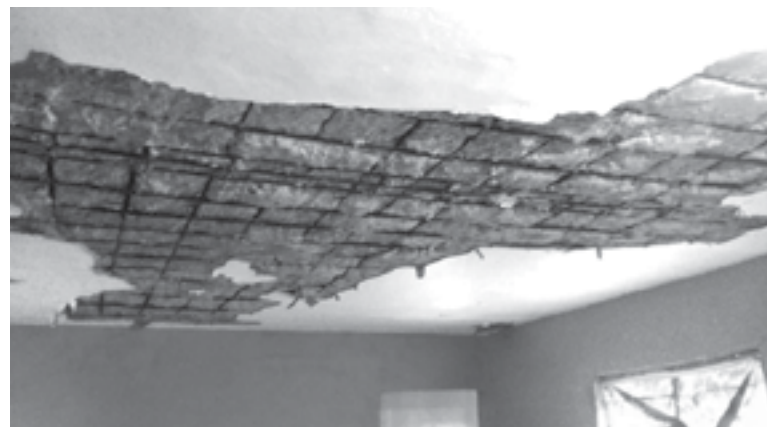
ASÍ QUEDÓ el techo de la vivienda.
