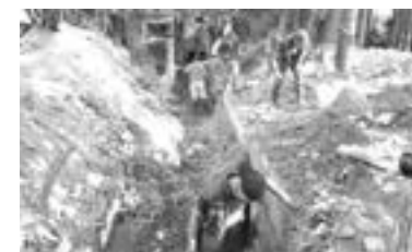
GENTE TIRA ESCOMBRO en drenes pluviales.
