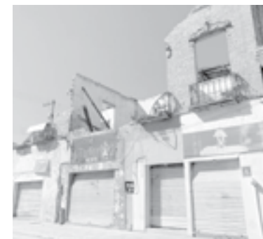
SERÁN RETIRADAS las partes peligrosas del edificio de la calle Juárez y Obregón.
