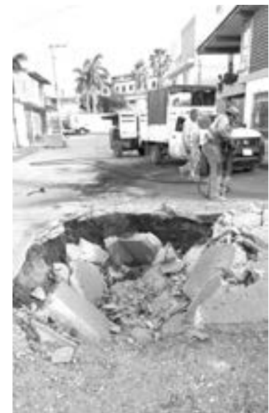
LA FRACTURA del pavimento en la calle Independencia fue atendida oportunamente por cuadrillas de Comapa Zona TAM.
