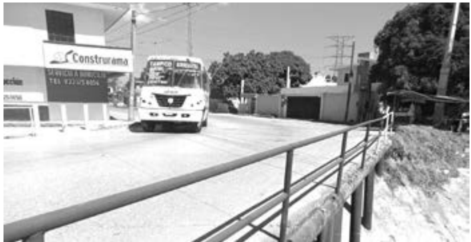
EL PUENTE está en malas condiciones.
