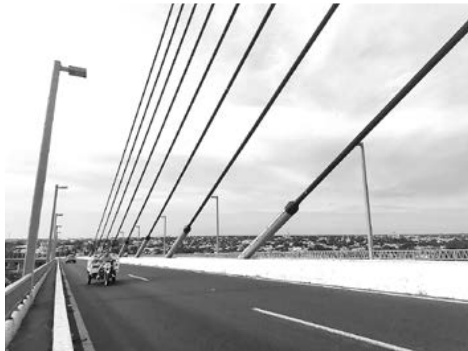
EN MAYO se detectaron “fallas” en el puente, pero no hay peligro.
