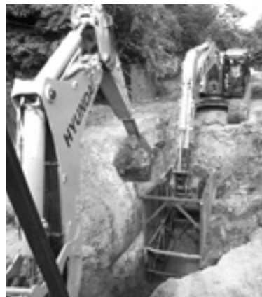
MANTIENE COMAPA ALTAMIRA reparaciones para evitar escurrimientos a la Laguna de Champayán.
