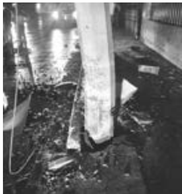
EL POSTE de concreto sufrió serias afectaciones.
