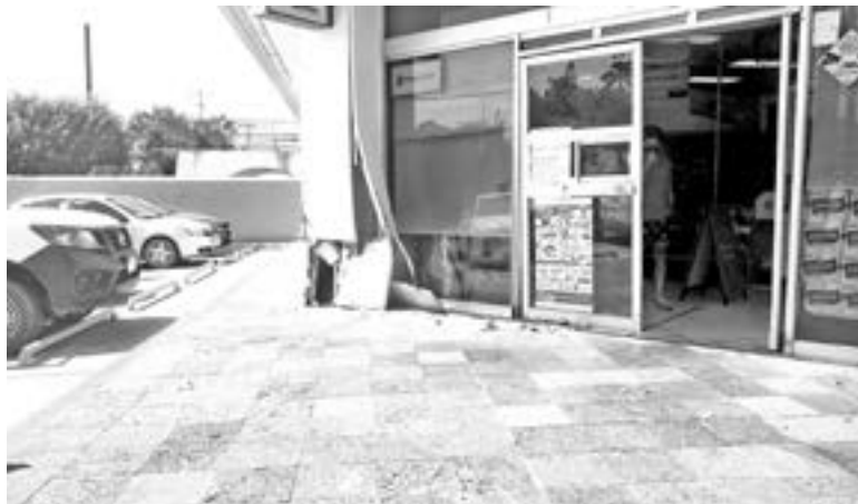
TAMBIÉN DAÑO la fachada del establecimiento.
