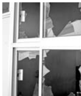
CAUSARON DESTROZOS a las instalaciones.
