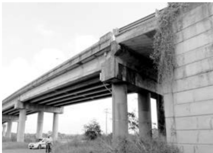
LA VÍA es peligrosa para quienes circulan por ella.
