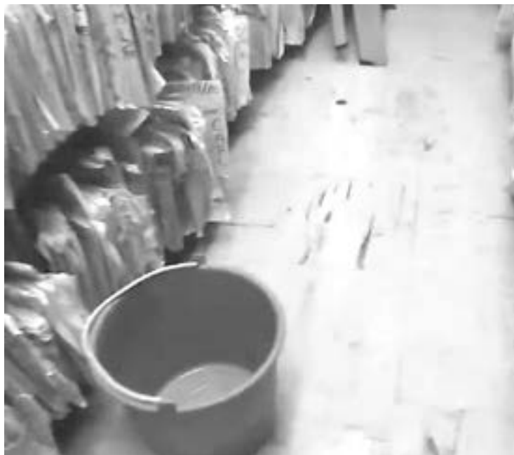
EN PÉSIMAS CONDICIONES están las instalaciones del hospital.
