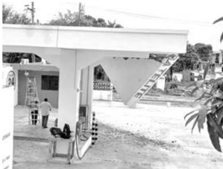
EL MARTES por la mañana colapsó una parte de la losa de este establecimiento.
