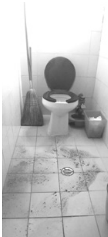
EL BAÑO no funciona.
