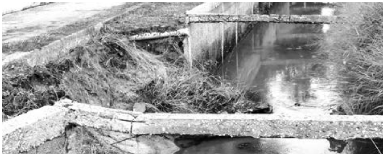
EL CANAL DEL CANGREJO presenta desprendimientos.
