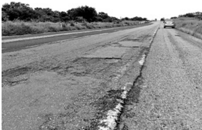
LA CARRETERA luce unos terribles hoyancos.
