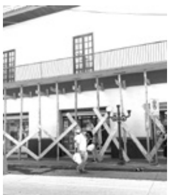
SE ESPERA el peritaje de Protección Civil.
