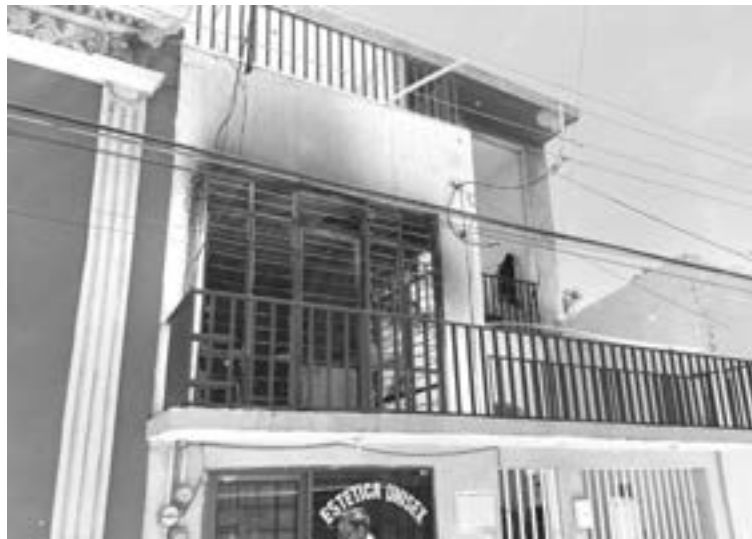
EL INCENDIO se registró en la planta alta de esta vivienda.
