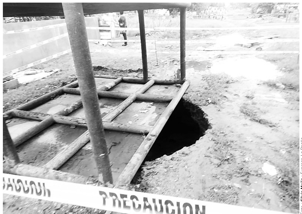
EL HOYANCO había sido delimitado para evitar accidentes.
